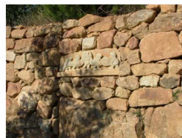
Fig. 5 – Relevo de Jorge Pé.Curto, como se se tratasse de um fragmento de friso, colocado no muro que acompanha o Caminho, antes da zona da plataforma das merendas.
